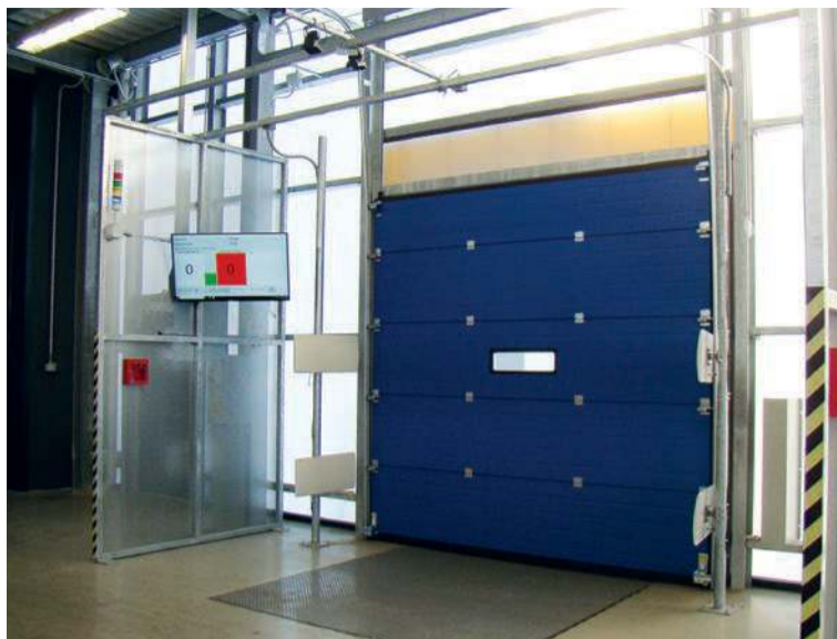
Uno dei varchi di entrata, anch'esso predisposto con lettori di etichette tag, antenne e video utili a monitorare la correttezza delle operazioni di scarico
